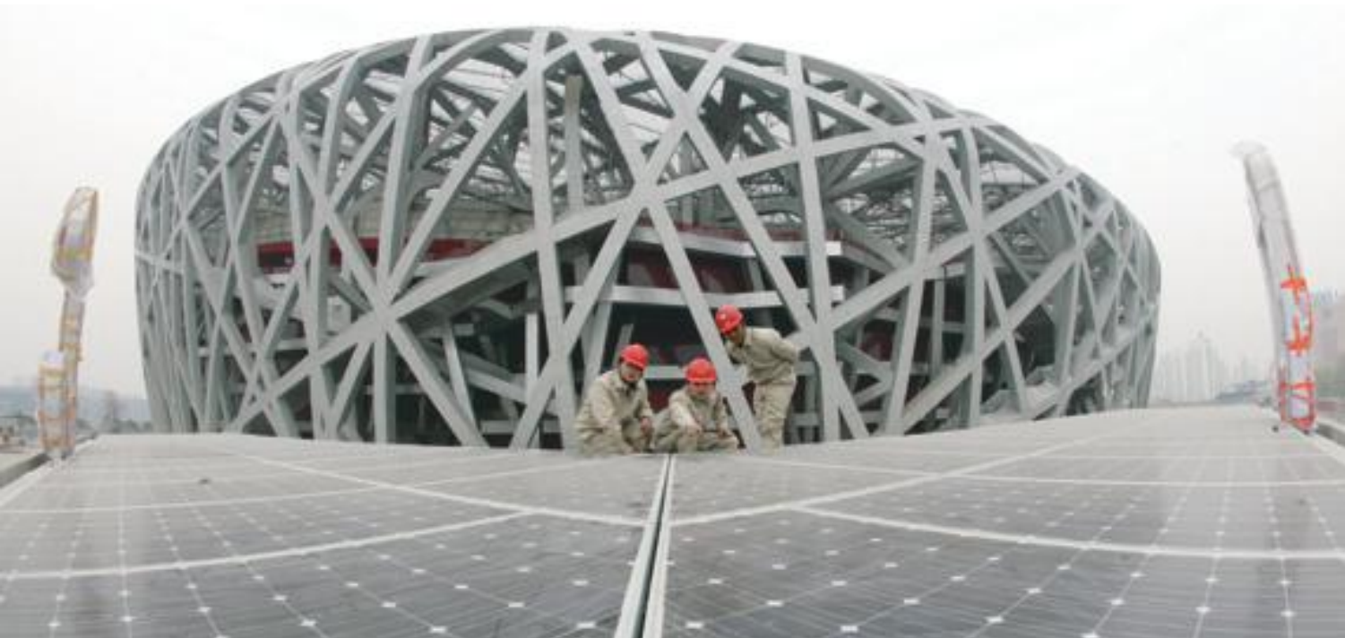
北京鸟巢体育馆光伏建筑一体化项目
