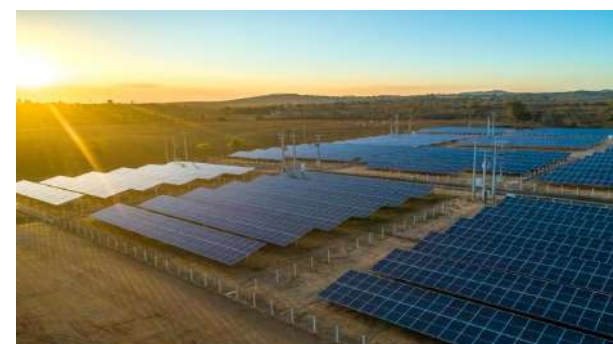
巴西-Setta太阳能电站项目
