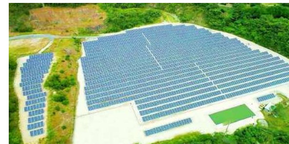
日本-神埼光伏发电站项目
